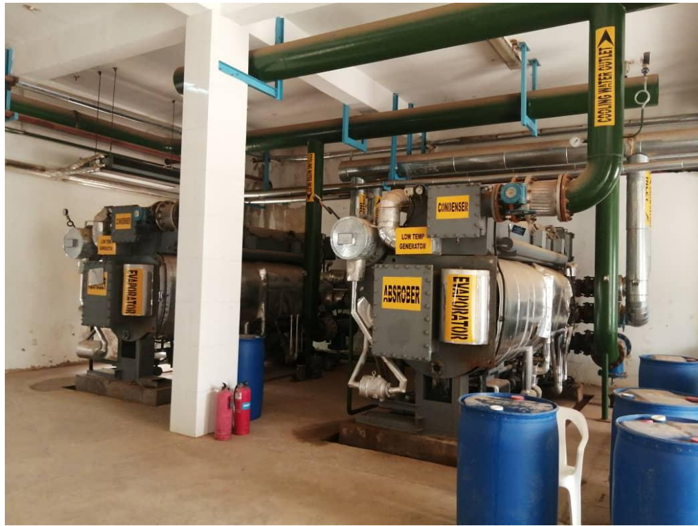
الشكل (3-4) مكائن التبريد (Chillers) بمصفاة الجيلي.
