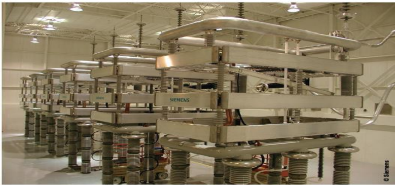
الشكل (3-2) : يوضح DC Converter Station
