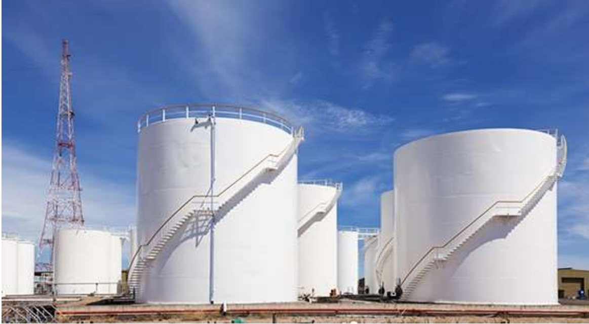
شكل (3-4) يوضح خزان الوقود داخل المحطة
