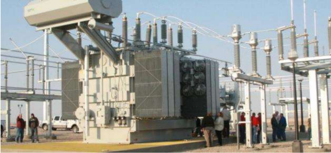
شكل(1-4) يوضح المحول داخل المحطة
