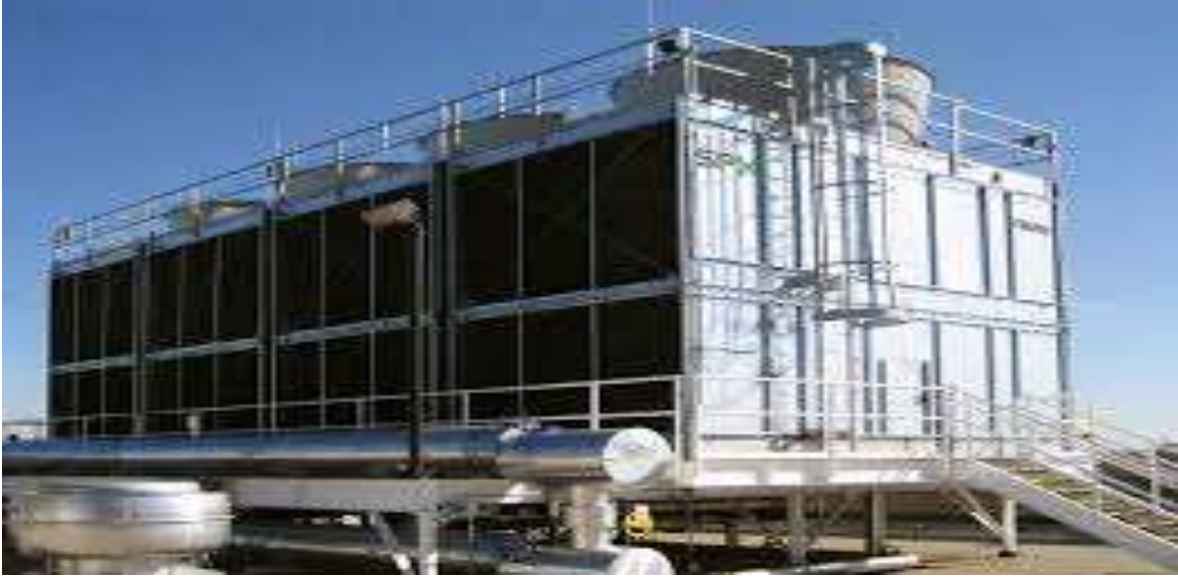
شكل(4-2) يوضح ابراج التبريد داخل المحطة
