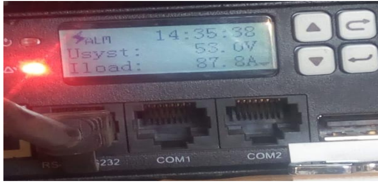
الشكل (1-5) الجهد والتيار في كنبنة برج الاتصالات
