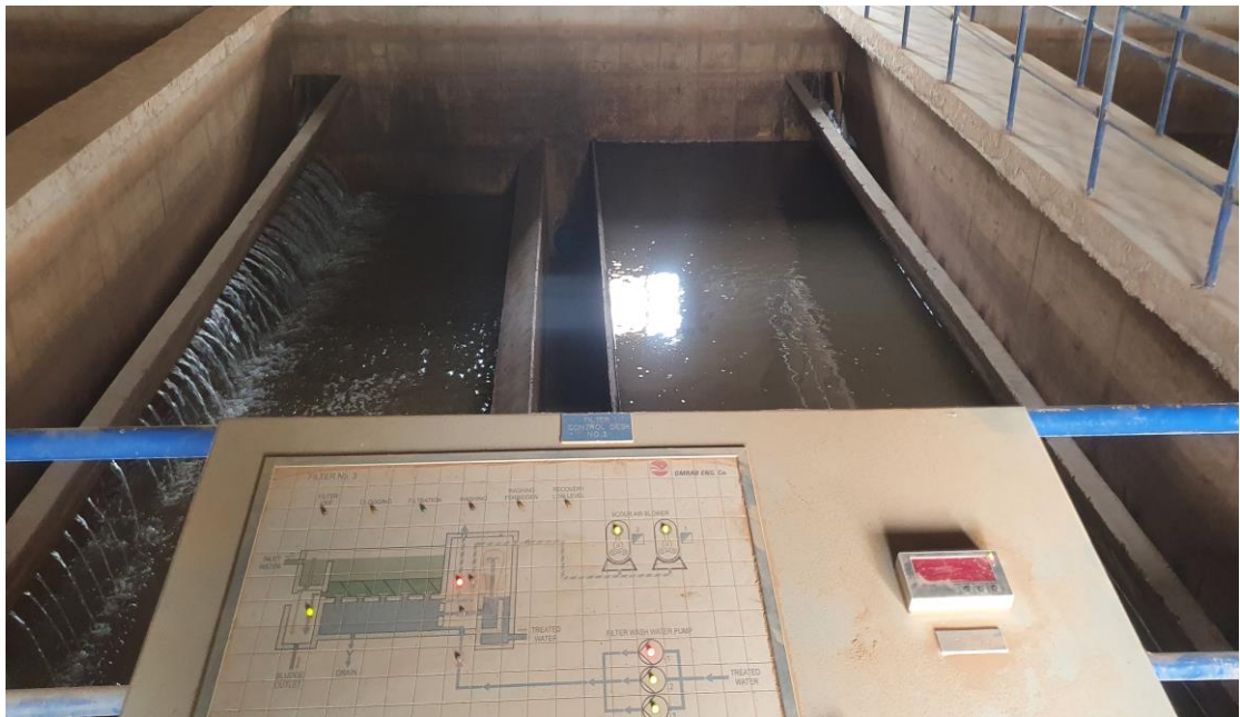
ملحق (F) يوضح حوض ترشيح بمحطة المقرن الجديدة (الدامر)
