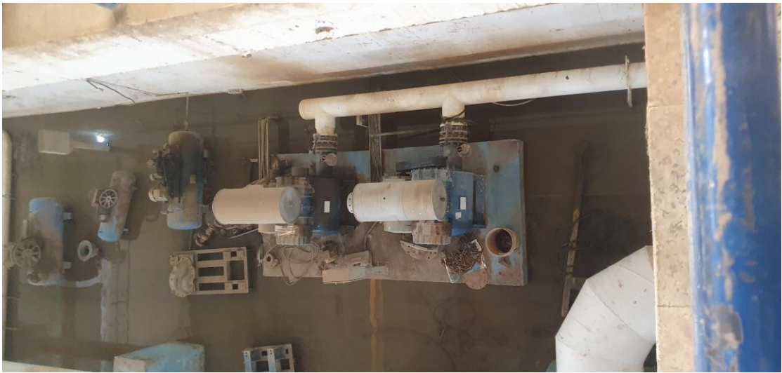
ملحق (I) يوضح مضخات الهواء لغسيل المرشح بمحطة المقرن الجديدة (الدامر)
