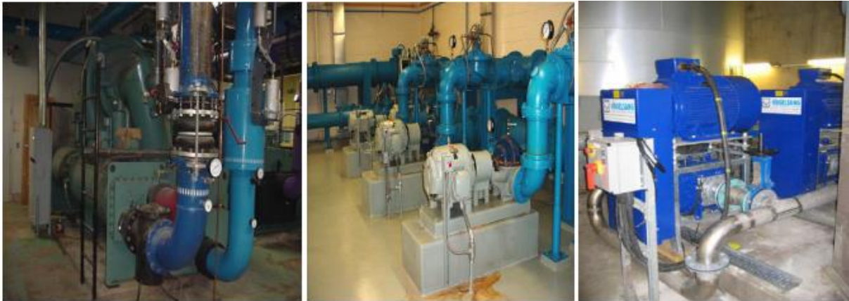
شكل رقم (2-8): مضخات رفع المياه.
